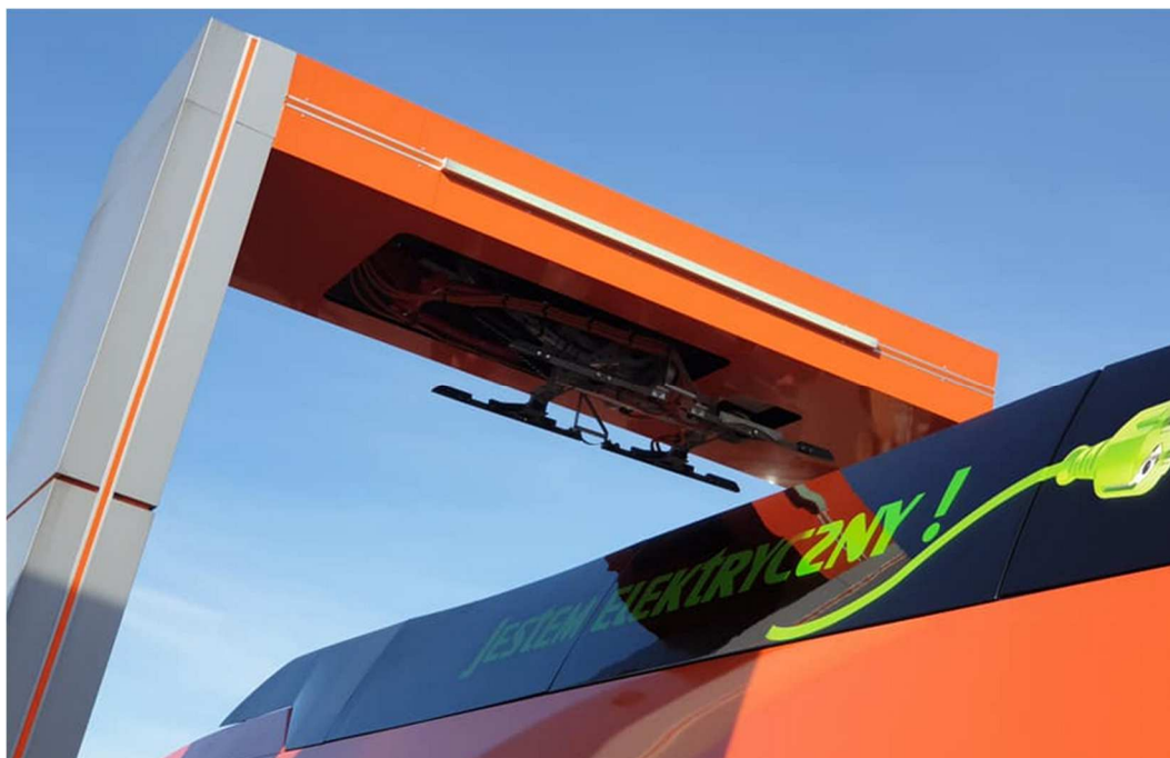
Rysunek 2.3-1 Stacja ładowania miejskich autobusów elektrycznych w Rzeszowie przy ul. Grottgera (źródło: https://ztm.rzeszow.pl/2788-2/ )
